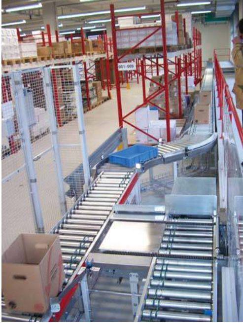
Förderstrecke in die Kommissionierung und Retourstrecke in den Versand
